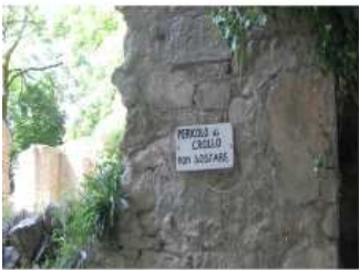
Chiesa di Casaglia. Pericolo di crollo
